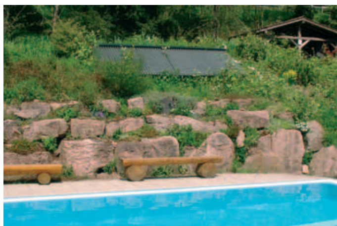
Das Schwimmbadwasser des Campings Langenwald (Freudenstadt) wird von Vakuum-Röhren-Kollektoren erwärmt. Preisgünstiger sind einfache Absorbermatten.
